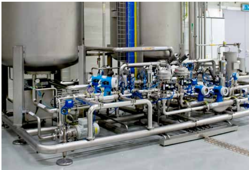
Terminal de válvulas en el sistema de mezclado de jarabe Multiblend
