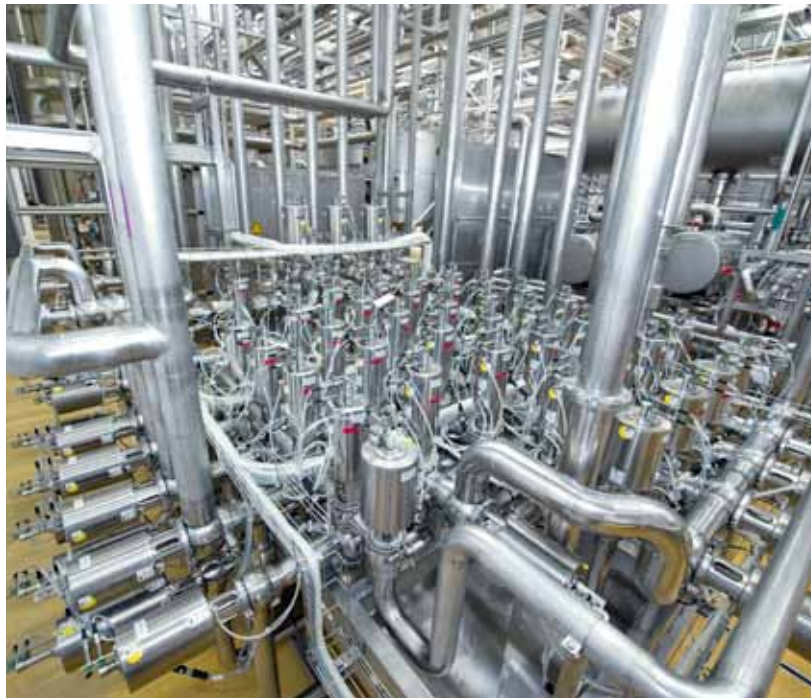
Conjunto de válvulas
