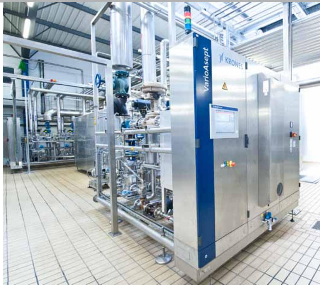
VarioFlash J en la sala de ingeniería de procesos
